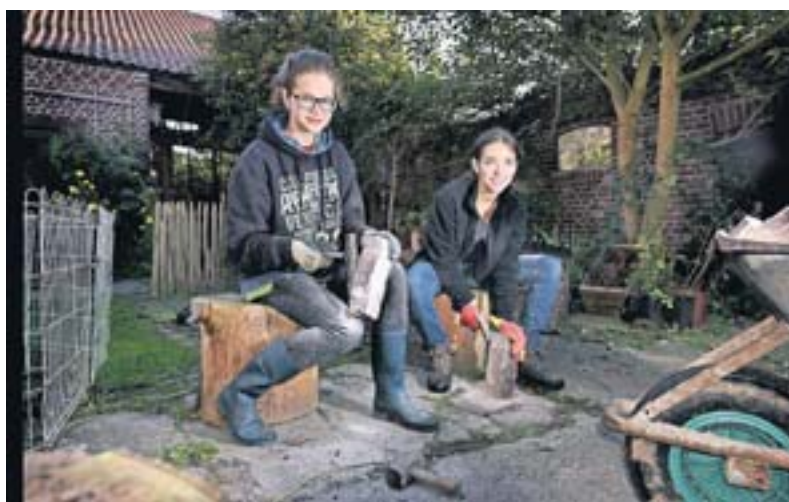
Hier wird die neue Pflasterung vorbereitet. Tatyana Bykova aus Russland (links) und Helene Esse aus Frankreich schaffen damit Nachhaltiges.
